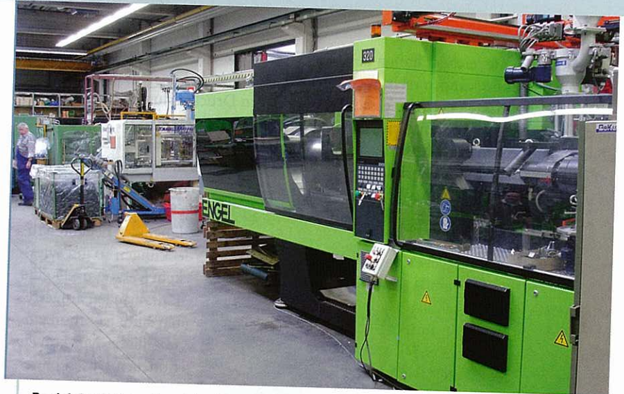
Produktiv: Die Leuchtenabdeckungen produziert Langer auf einer Engel-Spritzgießmaschine vom Typ 1050/200 mit 2 000 kN Schließkraft. Insgesamt verfügt man in Meschede über 42 Spritzgießmaschinen von Engel, Arburg, Krauss Maffei und Battenfeld, die in mehreren Hallen im Einsatz sind. Bilder: Bothur, Günther Heißkanaltechnik, Werner Langer
